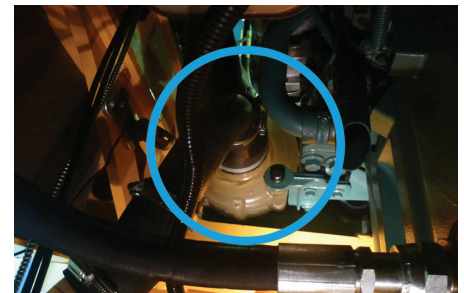
Bomba de agua instalada en un A30G para pruebas de funcionamiento.
